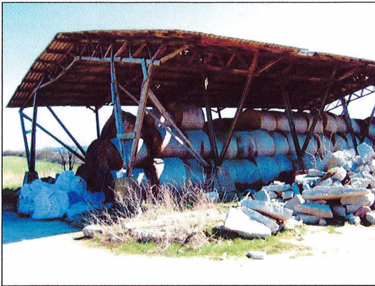
Abb. 5: Gegenwärtiger Zustand an der Bergescheune.
