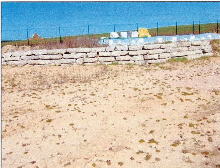
Abb. 6: Der Betonplattenbelag wurde in Stücken als Trockmauer verbaut, um eine Zufahrt seitlich zu festigen und den Höhenunterschied auszugleichen.
